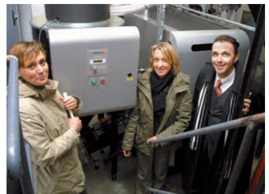
Cornelia Peer (Inhaberin HTEC, Kamp-Lintfort), Projektleiterin Miriam Kramp und Bürgermeister Dr. Ch. Landscheidt (v.l.n.r.) besichtigen die neue Biomasse-Heizanlage im „Kinderhaus Kunterbunt“.
